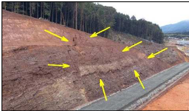
図-1 法面のクラック発生状況
