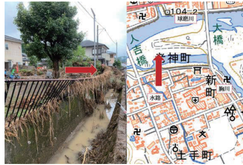
図-4 人吉地区の倒壊したフェンス
