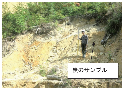
写真1 表層崩壊部の状況
