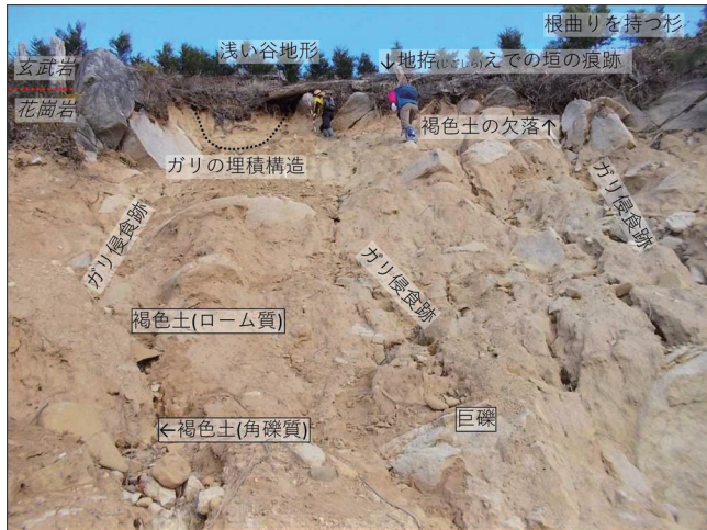
写真5 崩壊地Bの源頭部状況
