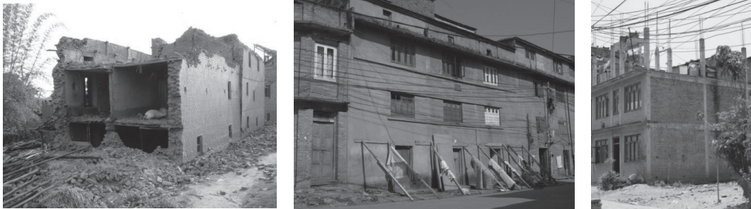
図3 住宅構造種別と被害 (左)レンガ造泥モルタル、バクタプール郡サラソーティ村 (中)レンガ造セメントモルタル、ラリトプール市 (右)RCC造、RC軸組壁にレンガ・セメントモルタル、バクタプール市
