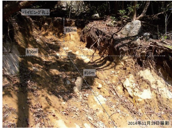
写真 1 Loc.1 の斜面崩壊
